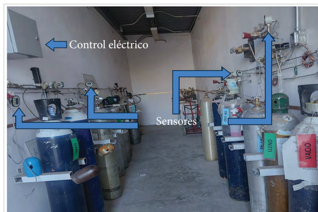
Figura 16. Zona de tanques.
