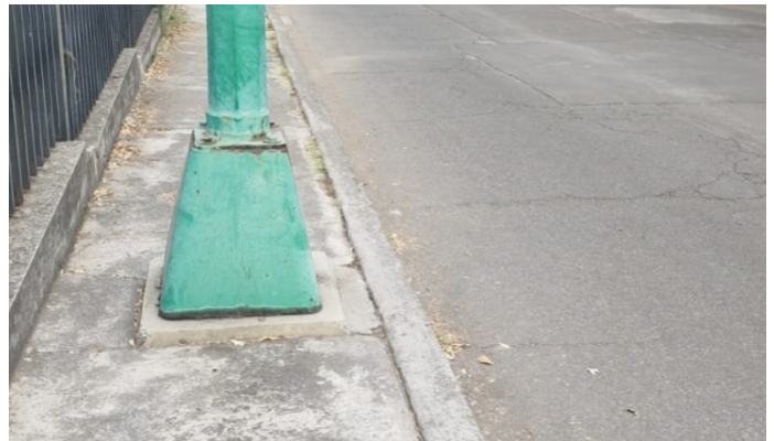
Figura 4. Banqueta mal diseñada debido a que es demasiado estrecha y tiene obstáculos para los peatones.
