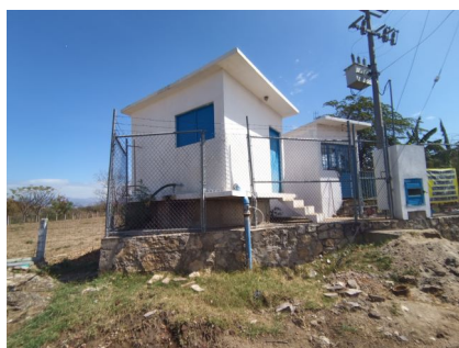
IMAGEN 2. Pozo del sistema de agua comunitario en Santo Domingo Dos.
